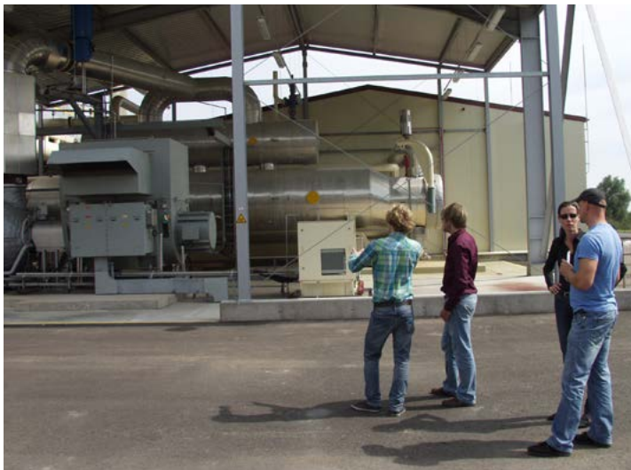
▲ Kraftwerksingenieur Dr. Dariusz Szablinski (rechts) erklärt den TIGER-Forschern Julian Halbey, Simon Himmel sowie Projektkoordinatorin Anna Borg die Funktionsweise des Kraftwerks Insheim. Die geothermische Anlage fährt momentan kontinuierlich ihre Leistung nach oben.
